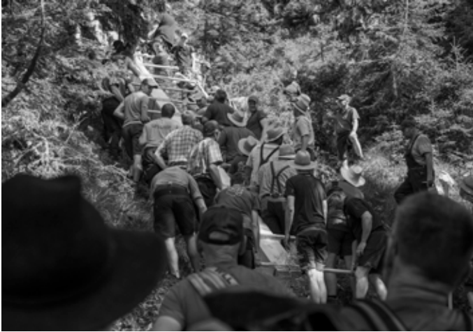
Bis zu 26 Mann tragen den 600 Kilogramm schweren Längsbalken hier oberhalb der Glaswandscharte.
